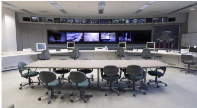
制御システム
